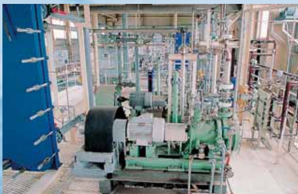
熱交換器基礎実験室 海洋温度差エネルギーなど、利用できる温度差が小さい場合には熱交換器の性能がきわめて重要になります。プレート式熱交換器を中心に、各種の形式の熱交換器の基礎的・応用的研究や熱交換器の性能評価を行っています。
